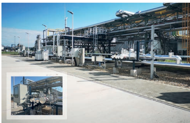
Außenstellflächen des HLL mit Pipelinesystem für Langzeit-Systemtests von Elektrolyseursystemen, Foto: © Fraunhofer IWES
